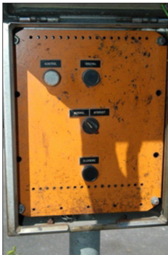
Betjeningskasse ved Nordkajen.
