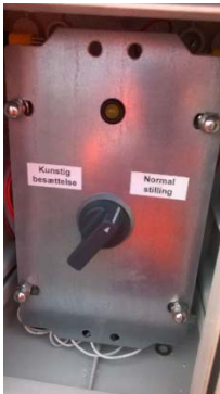
Stedlig dækning udkoblet:
