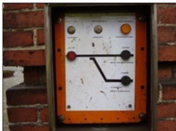
Betjeningskasse på husgavlen ved firmaet H. Daugaard.
