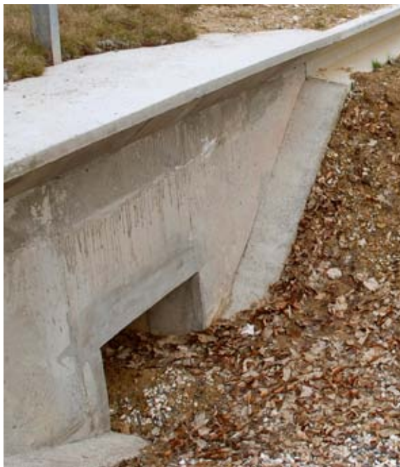
Eksempel på padde- og smådyrspassage under vej. Disse passager bygges for hver 250 m på hele strækningen, hvor banen anlægges over terræn.
