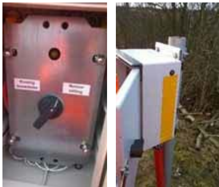
Stedlig dækning udkoblet
