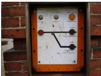
Betjeningskasse på husgavlen ved firmaet H. Daugaard.
