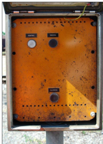
Betjeningskasse ved Jens Holms Vej.
